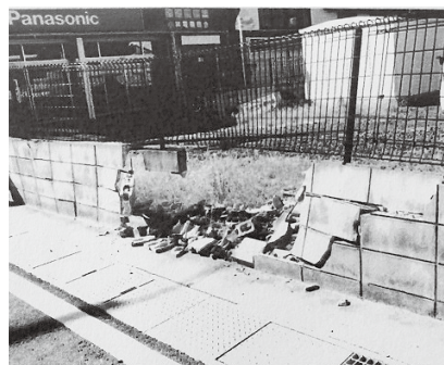
交差点事故で壊れたブロック塀
