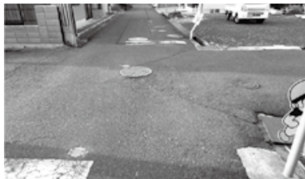
(村井地先のマンホールと凹み)
