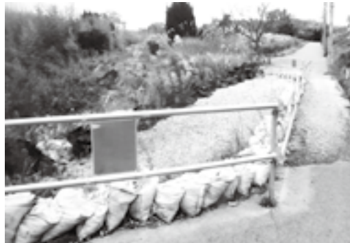
五月台団地内道路の災害現場の現状
