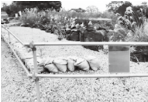
台風21号の地滑り被害の修復現状
