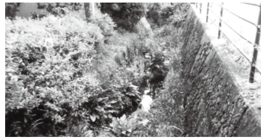
60m区間で土砂堆積し、草が繁茂
