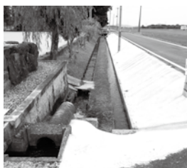
▲中在寺草の根ひろば前 農道路肩法面
