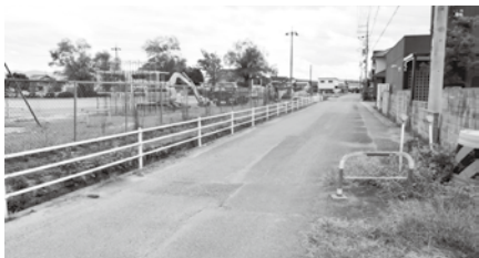
必佐小学校グラウンド内で工事が進む町道小御門十禅師線
