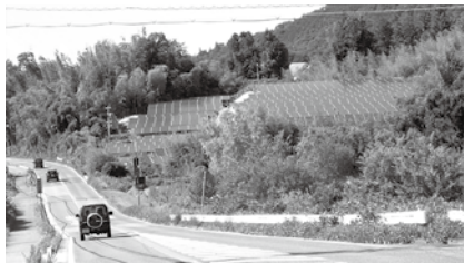
▲国道307号沿いにある太陽光発電(500KW)
