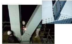
<鋼材のき裂発生時対応に 関する技術者の派遣>
