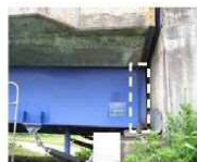
<腐食端部の腐食>
